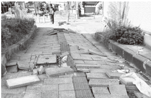
▲地震発生から約9カ月経過してもなお倒壊したままの建物や隆起したままの道路状況（9月14日、輪島市）
